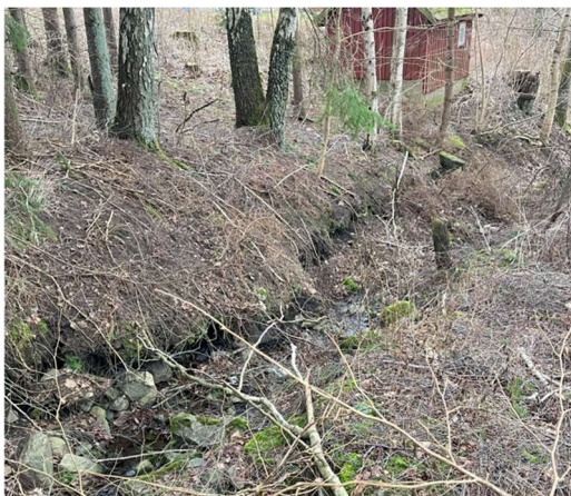
Figur 17 Bild på erosion ner mot damm 2.
