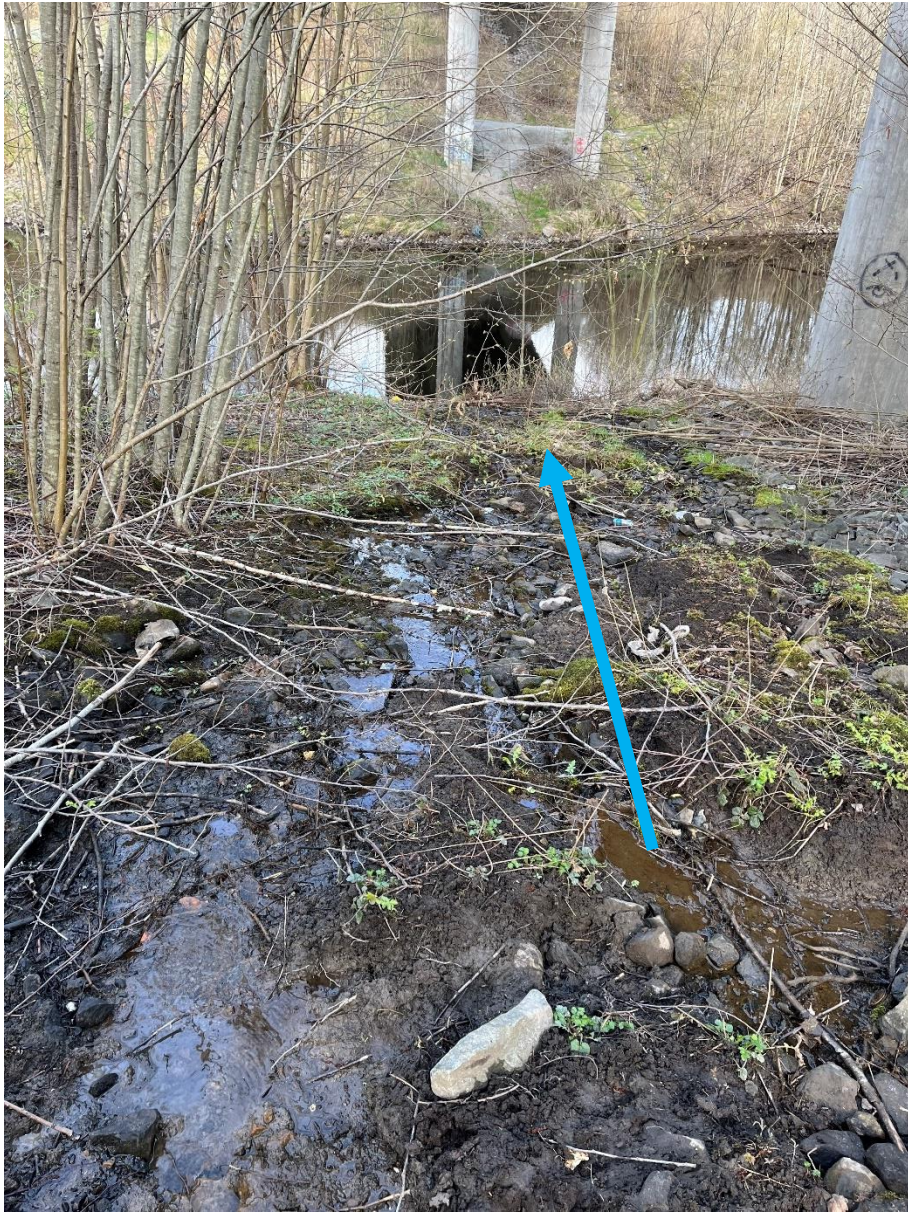
Dagvattnet rinner ner norrut mot Viskan. Stora delar av erosionskyddet (utlagd sprängsten) är borta.
