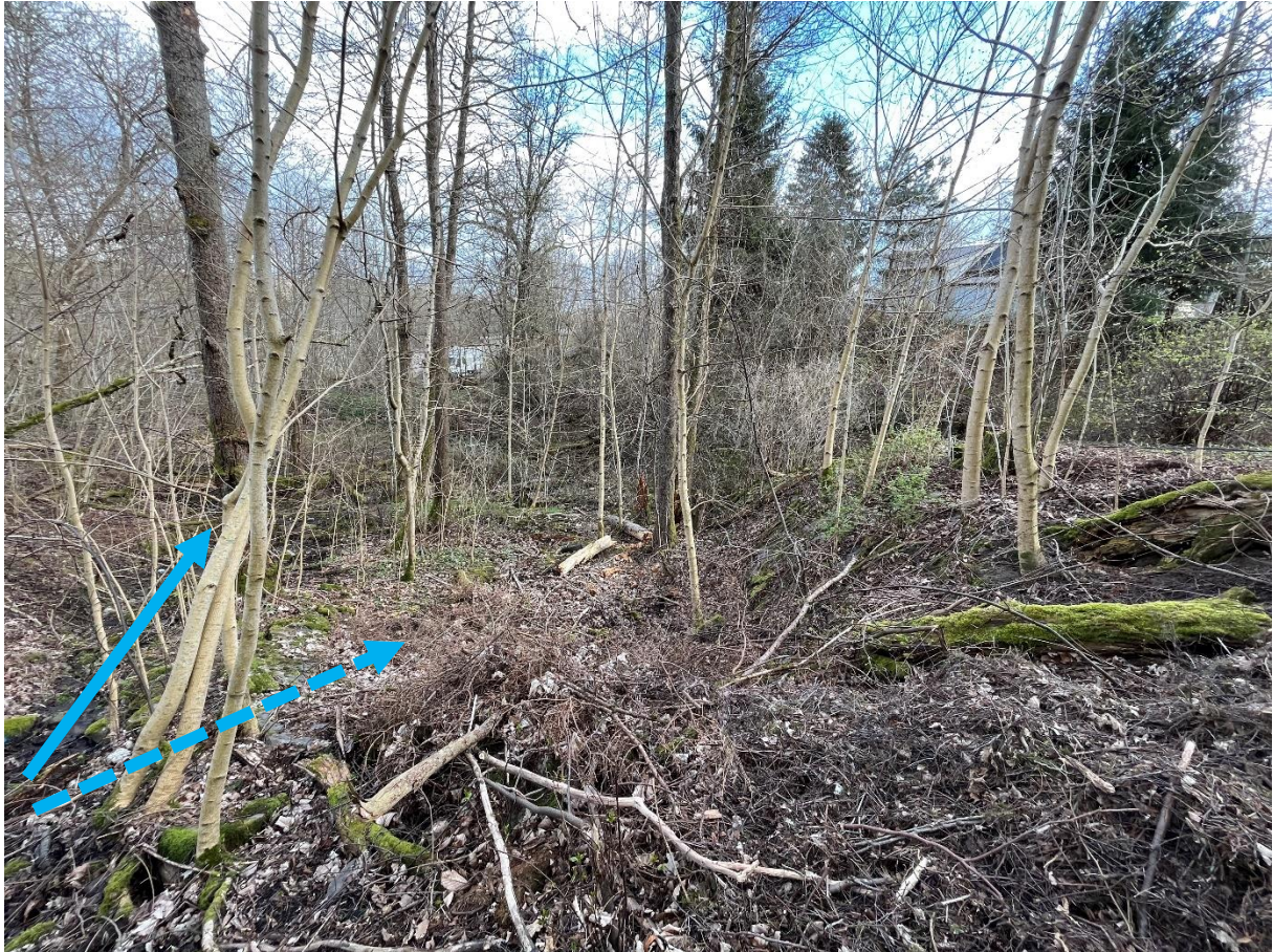
Befintlig damm för fördröjning av stora flöden. Slänten står mycket brant och erosionsskydd saknas.
