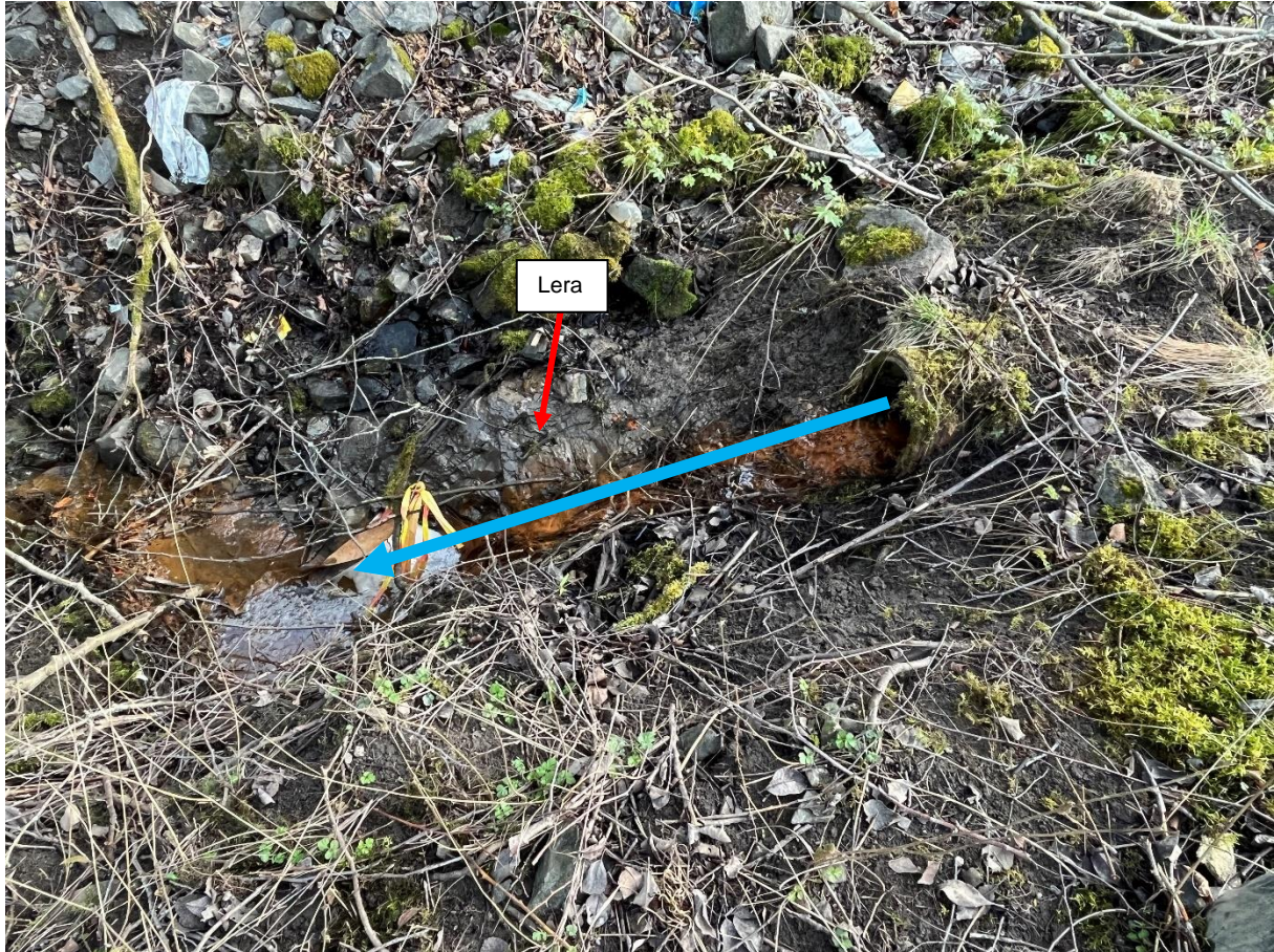
Dagvattnet rinner ut ur trumman och vidare söderut mot Viskan. Tydlig erosion, lera har eroderat fram.
