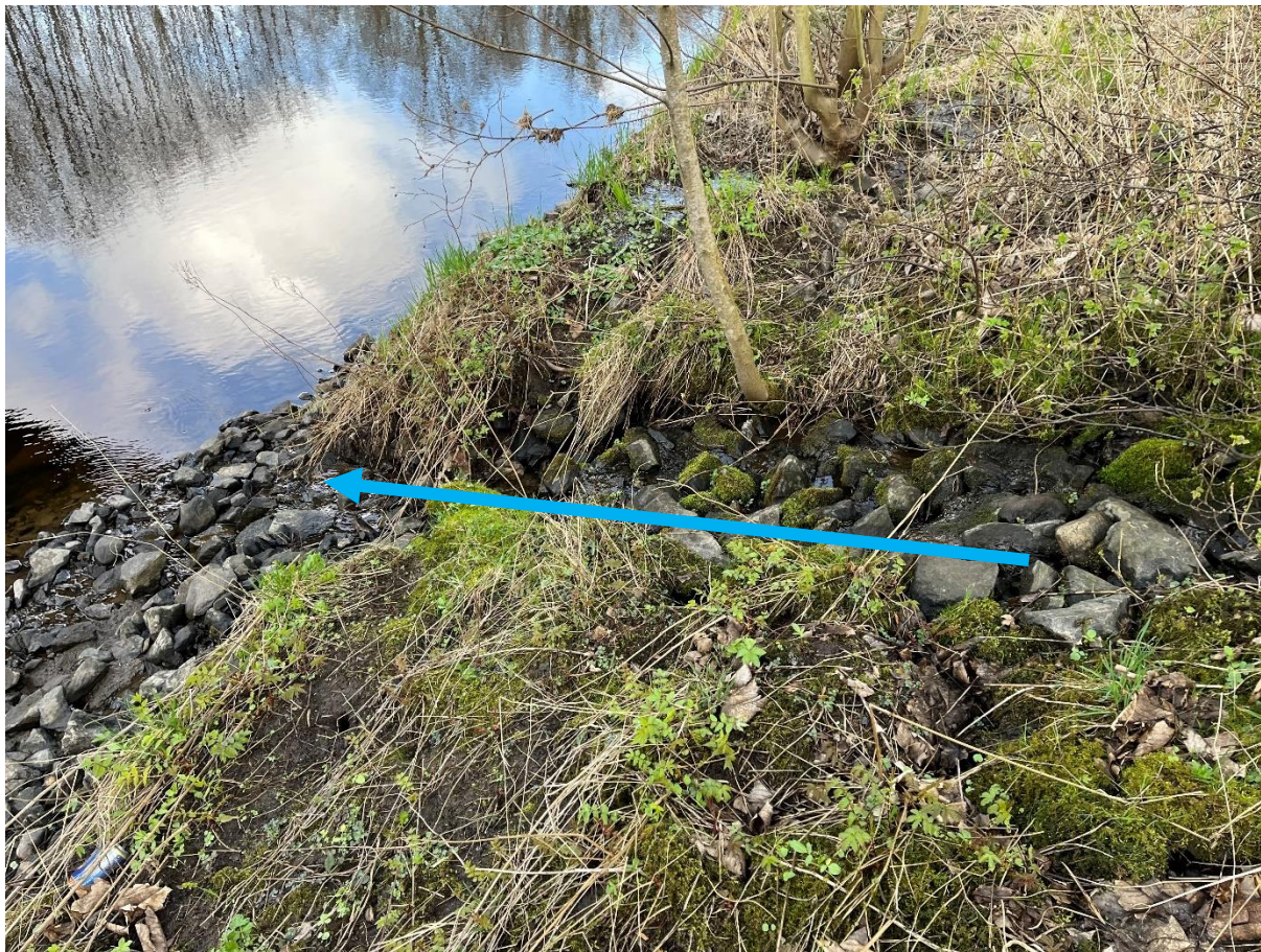
Dagvattnet rinner ut i Viskan i erosjonsskyddat dike.
