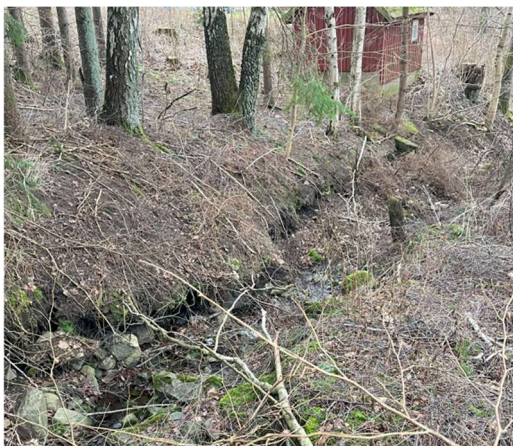
Figur 17 Bild på erosion ner mot damm 2.
