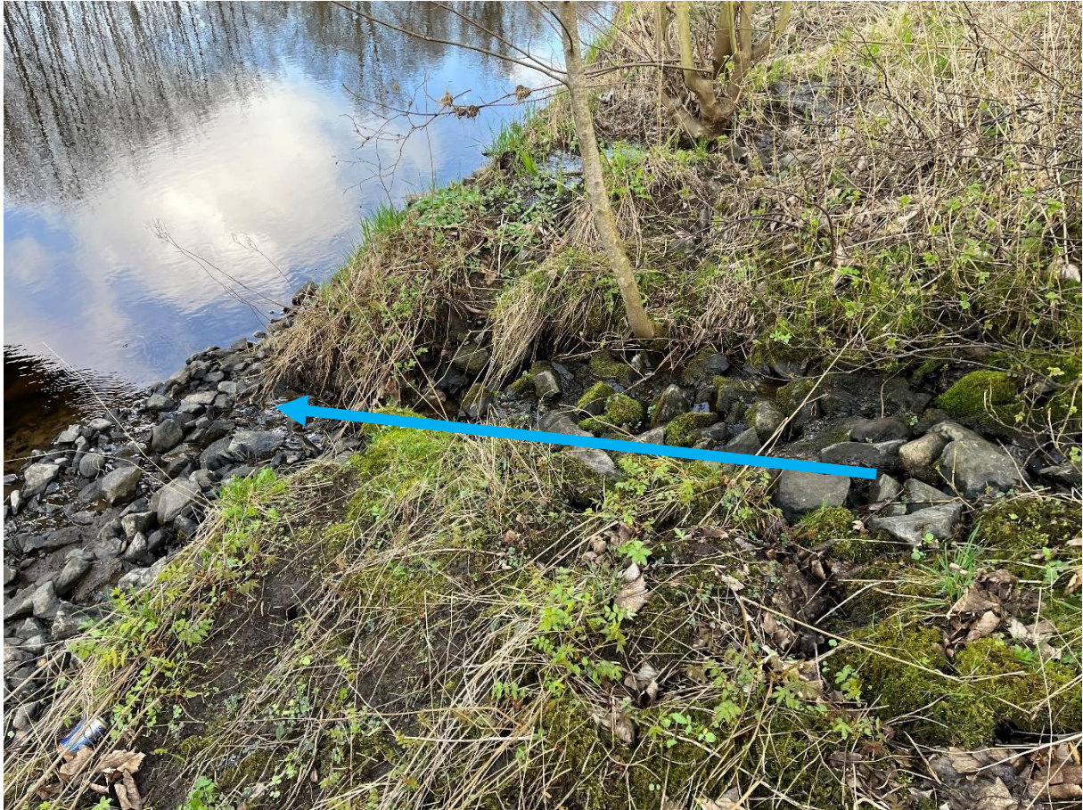
Dagvattnet rinner ut i Viskan i erosionsskyddat dike.
