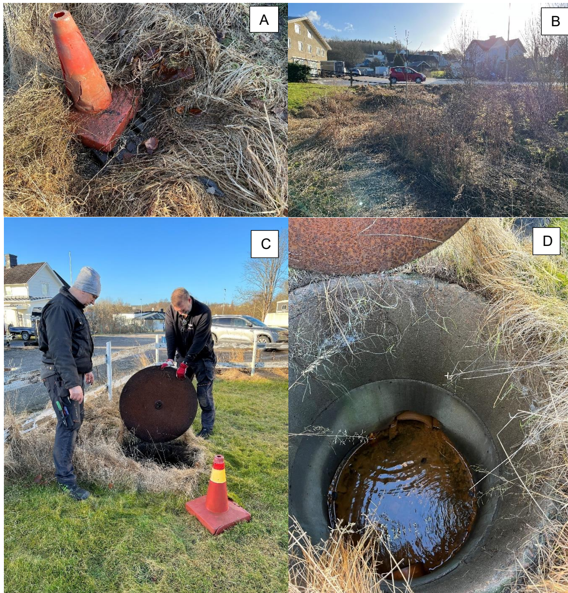
Figur 6. A: Dagvattenbrunn som sväljer vattnet från södra delområdet, B: Utlopp i bäckravinen, C och D: Kontroll och rensbrunn för dagvattenledningen.
