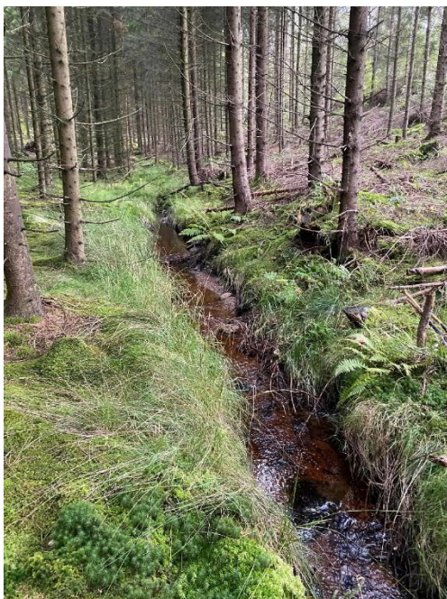
Figur 8. Naturligt dike som går genom planområdet. Diket leder avrinnande dagvatten från omgivande naturmark genom den norra trumman (BTG 800 mm) in i planområdet och sen genom den södra trumman (BTG 600 mm) ut från planområdet. Bilden tagen under platsbesök 2021-09-27. (Från Sweco, 2021)
