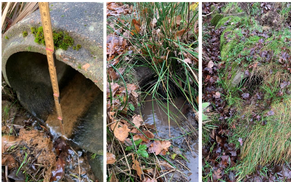
Figur 8. Till vänster: Trumma under spillvattenledning vid ravin 5b. I mitten trumma under spillvattenledning vid ravin 5a. Till höger: Trumma under spillvattenledning vid ravin 3. (Källa: Kungsfors fabriker)
