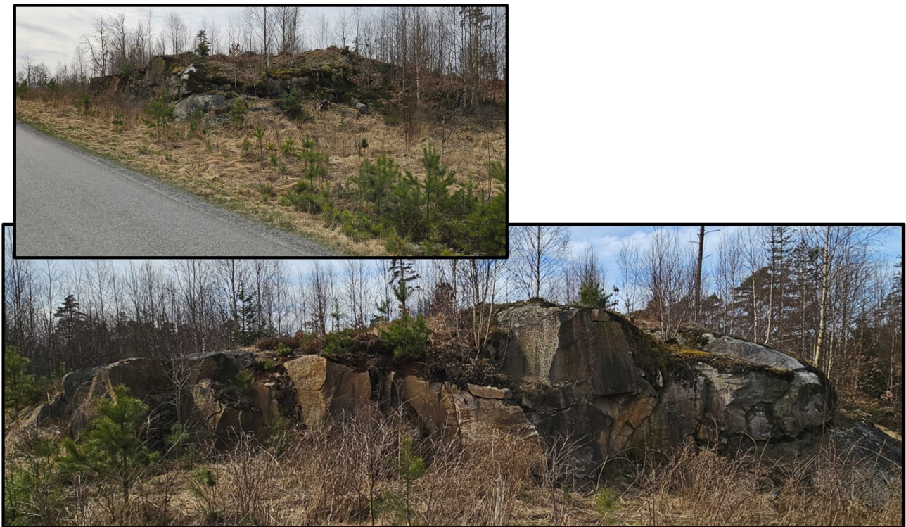
Figur 7. Bergslänt längs Jägmästarvägen med relativt stor sannolikhet för blocknedfall av mindre storlek.
