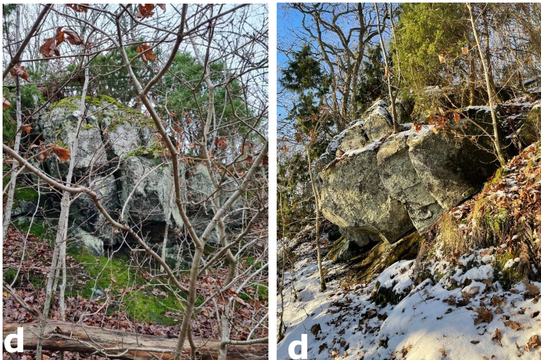
Figur 1-7. Område 1. Vy mot N respektive O. Slänt mot Kalvviksvägen. Parti med större block staplade på varandra. Block vilar på glidyta med stupning ca 40° ut mot Kalvviksvägen. Sannolikhet för utfall bedöms som måttlig. Block bedöms kunna nå vägbana vid utfall. Block bör rensas/tas ned alternativt förankras i bakomliggande, stabilt, berg.
