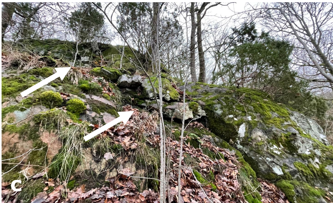
Figur 1-5. Område 1. Vy mot N. Slänt mot Kalvviksvägen. Slänt med bristande lokalstabilitet. Läge för potentiellt instabila block redovisas, se även figur 1-6. Sannolikheten för utfall bedöms vara mycket hög. Block bedöms kunna nå vägbana vid utfall. Vegetationsrensning och skrotning av lösa block rekommenderas.
