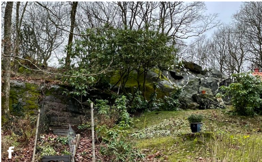
Figur 1-9. Område 2. Bergslänt in mot angränsande fastighet. Potentiellt instabila block redovisas med vit, streckad linje. Bergslänten mot angränsande fastighet bör synas före markarbeten/berguttag för att avgöra lämplig åtgärd.
