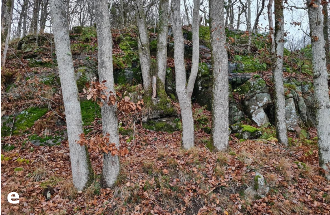
Figur 1-7. Område 2. Slänt mot Kalvviksvägen. Vy mot N. Block vilar generellt på subhorisontella sprickplan varför risken för utfall bedöms vara låg för befintliga förhållanden. Nedtagning alternativt förankring av enskilda block kan bli nödvändigt vid markarbeten/berguttag.
