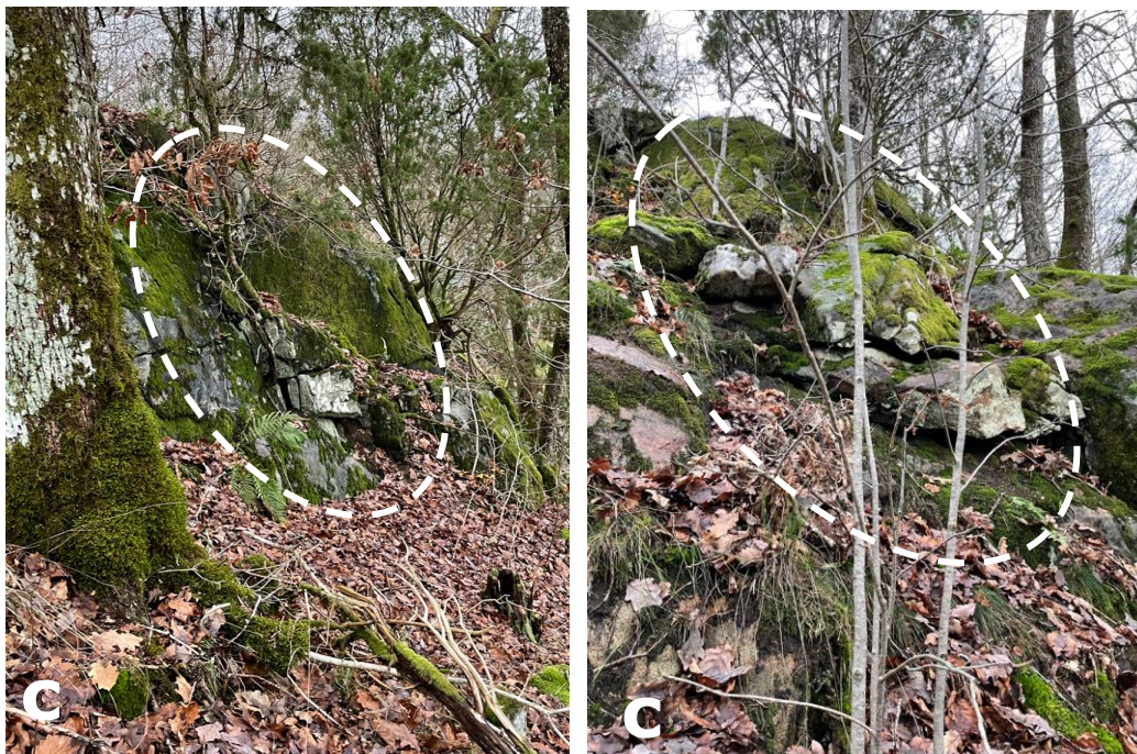
Figur 1-5. Område 1. T.v. Detaljbild potentiellt instabila block. Block strax under slänkrön. Block vilar på subhorisontella ytor och bedöms i nuläget stabila, vegetation i bakkant kan medföra framtida instabilitet. Vegetationsrensning och skrotning av lösa block rekommenderas. T.h. Detaljbild potentiellt instabila block. Lösa block på sluttande yta ut mot Kalvviksvägen,rensning av lösa block rekommenderas.
