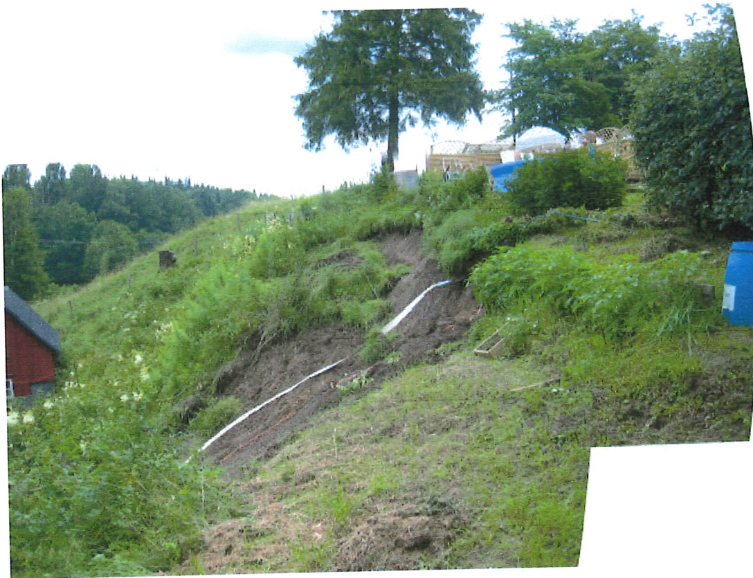
Bild 3 : Släntskredet från söder
