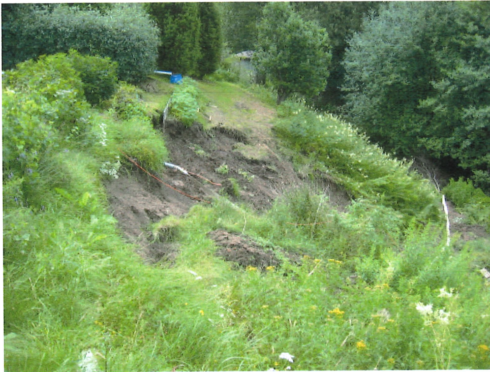
Bild 5 : Släntskredet från norr
