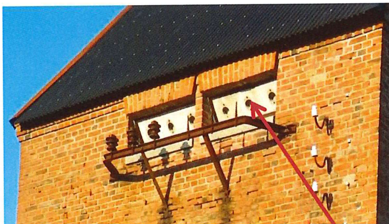
Figur 7. Kabelgenomföring som skulle kunna innehålla asbest.
