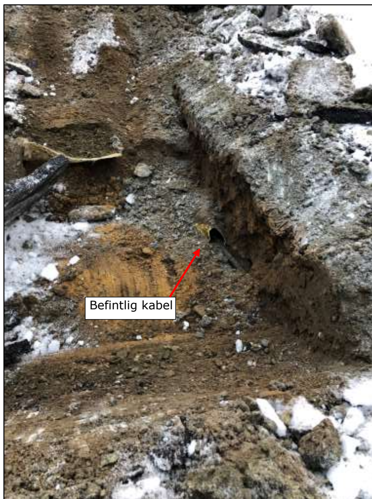
Figur 8. En av de befintliga kablarna som påträffades i provpunkt 21AF06. Foto: AFRY.
