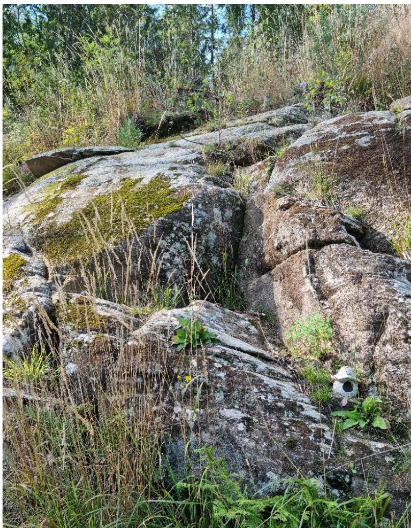
Figur 5-4. Blocket som har fallit ut visar typisk blockbildning i skärningen vid undersökningspunkt två.
