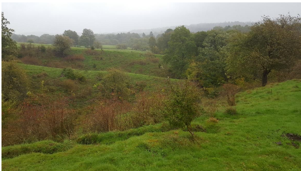
Figur 13. Foto med tecken på rörelse vid kanten av ravinen. (Källa: Tyréns)
