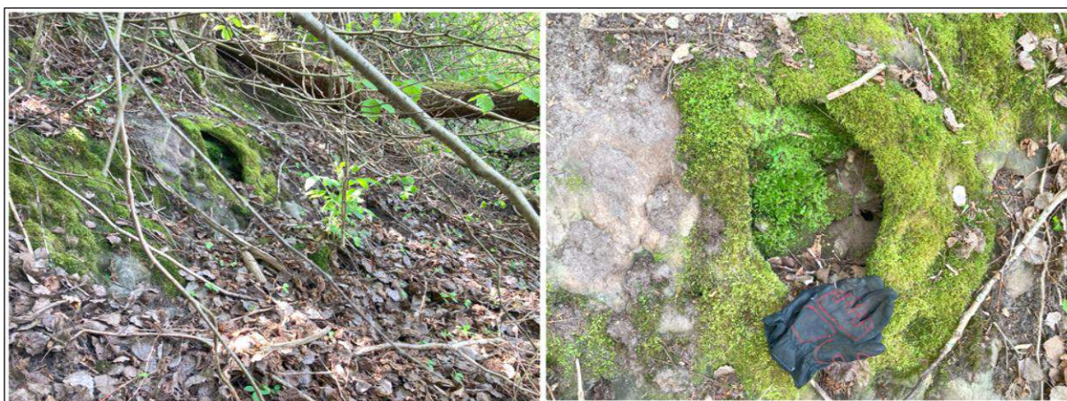
Figur 6: Bilder som visar en del av skadorna som observerats i betongmadrassen.
